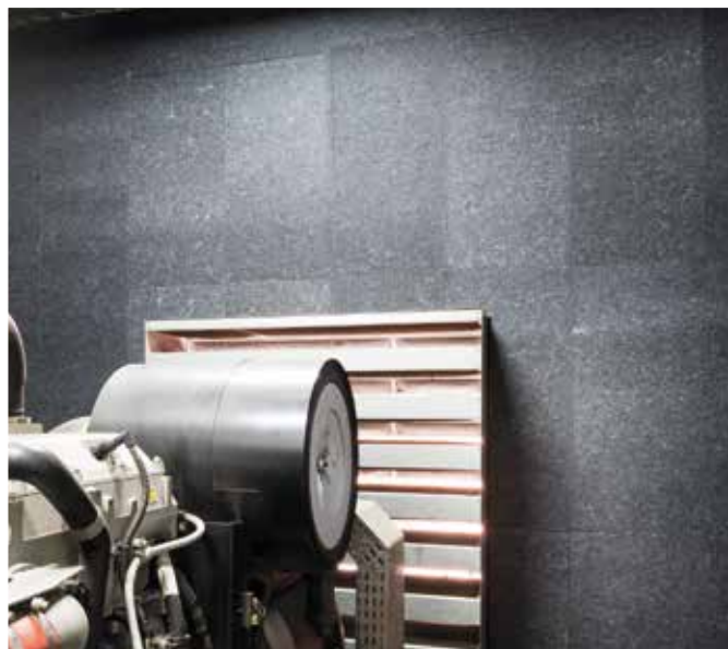
Casa de máquinas
